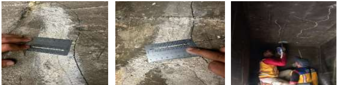
Sumber: (Hasil Tinjauan Lapangan Jembatan Maribaya A Ruas Jalan Bts. Kota Tegal - Bts. Kota Pemalang KM. 153+300, 2024) & (Susanto & Kurniawan, 2024)
