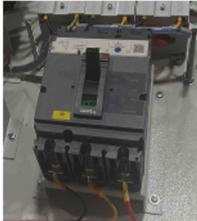
Gambar 13. MCCB Pada panel Star Delta Heydrant.
